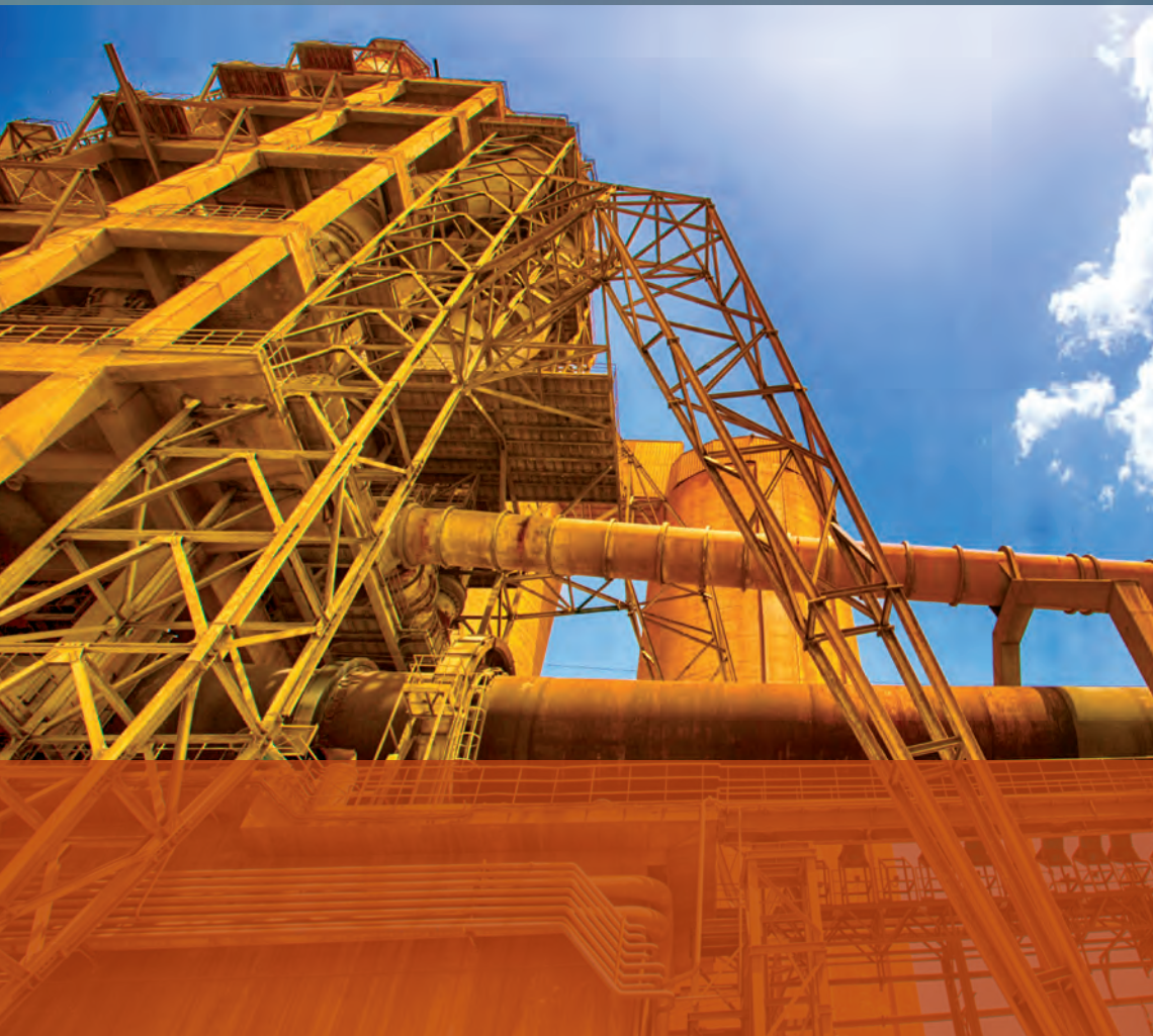
Vista da torre de pré-aquecedores e pré-calcinador
