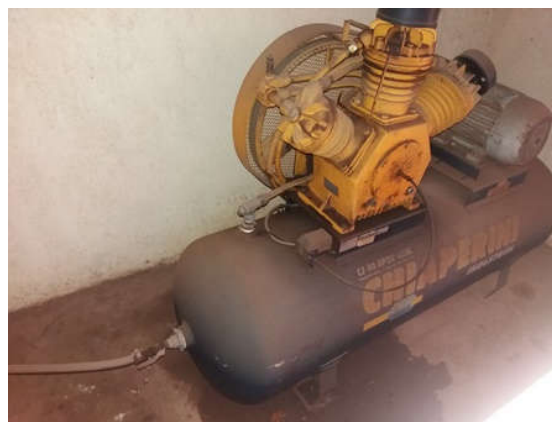
Foto 26. Resíduo de resíduo oleoso proveniente do compressor, diretamente no piso.
