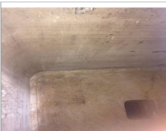
Foto 19. Caixa coletora sem efluente.
