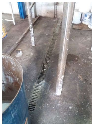
Foto 12. As canaletas sem a devida manutenção.
